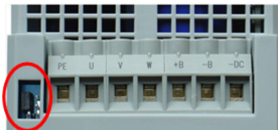
Partie inférieure des appareils
