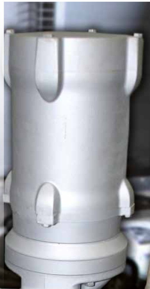
Motoréducteur nsd tupH après 12 mois d'exploitation
